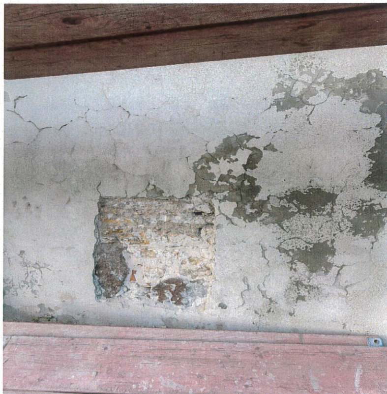
WIDOK ZABUDOWY – Ściany ELEWACJI TYLNEJ, OD STRONY POŁUDNIOWEJ BUDYNKU DZWONNICY-różny materiał muru pierwotnego, spękania pajęczynowate
