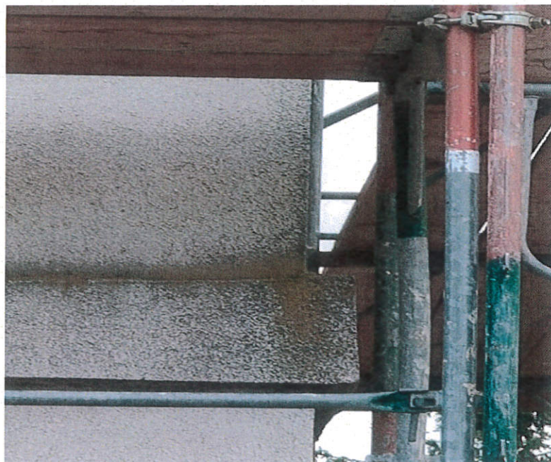
WIDOK GZYMSU nad poziomem przyziemia widoczne działanie wody i porost glonów
